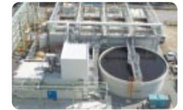
活性汚泥処理装置
