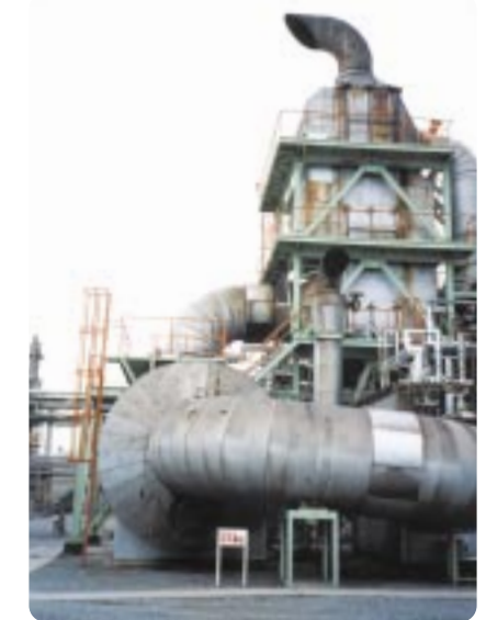
排ガス処理装置
