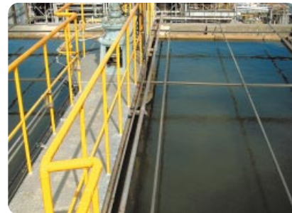
活性汚泥処理装置
