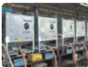
再生水を利用するコンテナ洗浄
