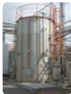
新設の再生水用タンク
