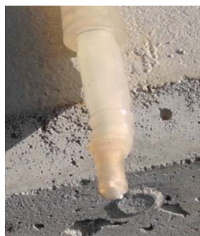
排気ベント 凝縮液の重合物
