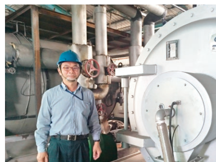
天然ガス燃料のボイラー
