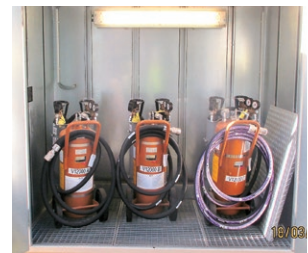
重合禁止剤投入用混合ガスボンベ
