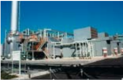
コージェネレーションシステム
