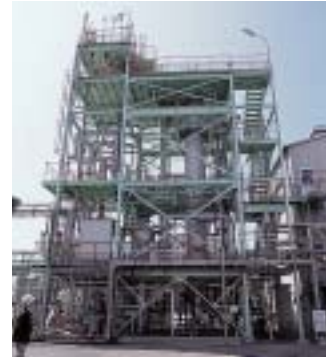
排水処理装置
