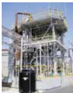
日宝化学のヨード回収・再製品化設備
