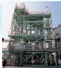
排水処理装置
