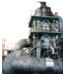
ベンゼン排ガス処理装置
