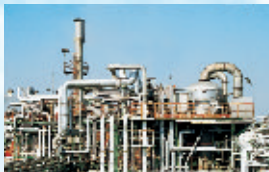
廃液燃焼装置
