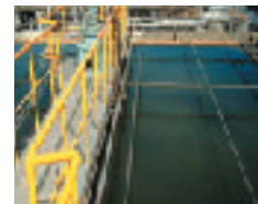
新活性汚泥処理装置
