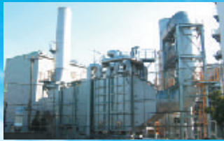
コージェネレーションシステム
