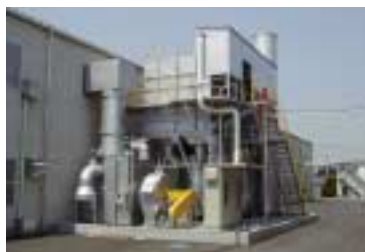
中国化工の新方式脱臭装置
