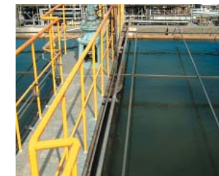
新活性汚泥処理装置
