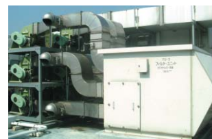
活性炭の吸着槽
