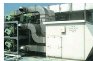
活性炭の吸着槽
