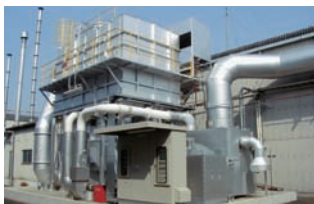
排ガス処理装置の更新
