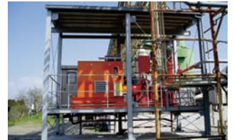
水噴霧消火設備のポンプ
