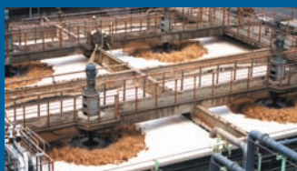
活性汚泥処理装置
