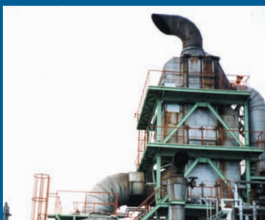
排ガス処理装置
