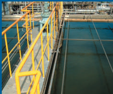
活性汚泥処理装置
