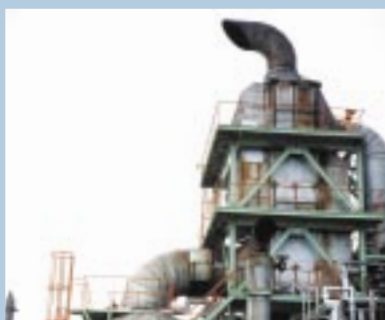
排ガス処理装置
