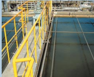
活性汚泥処理装置
