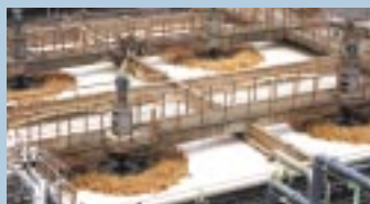
活性汚泥処理装置
