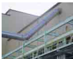
廃ガス処理装置
