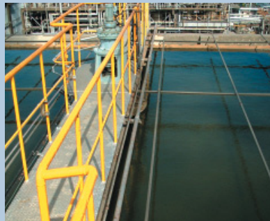
活性汚泥処理装置
