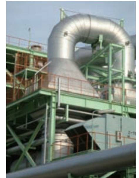
排ガス処理装置
