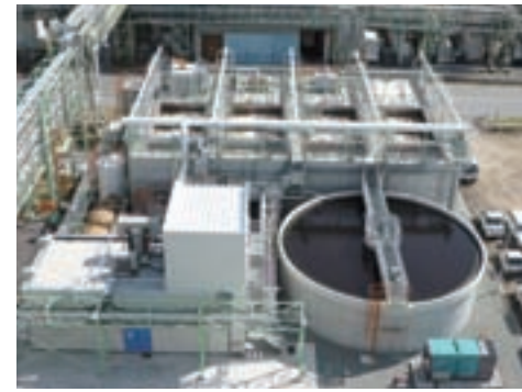
活性汚泥処理装置
