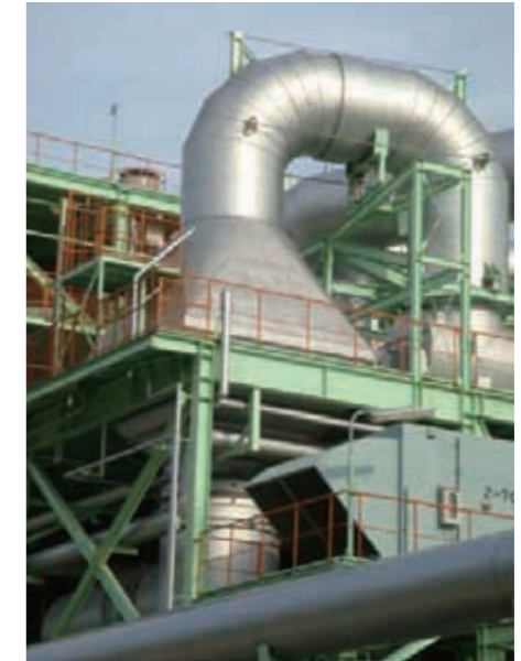
排ガス処理装置
