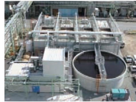
活性汚泥処理装置
