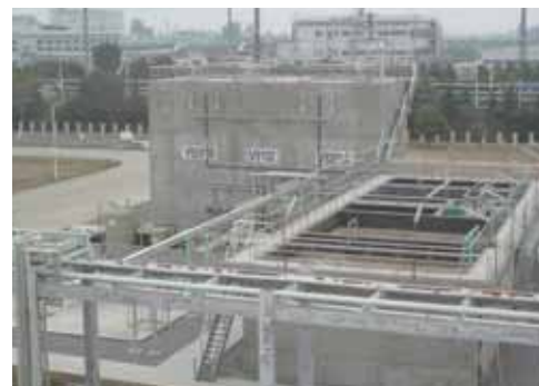
新規活性汚泥処理設備
