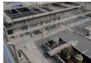
新規活性汚泥装置
