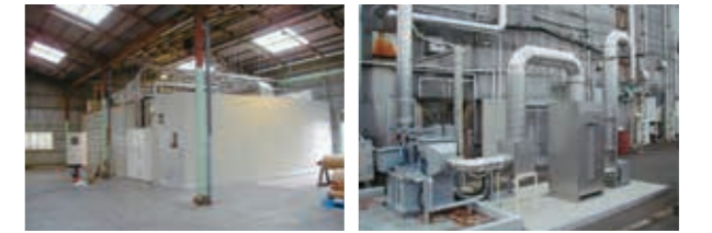
クリーンルーム
