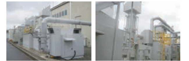
排ガス処理設備
