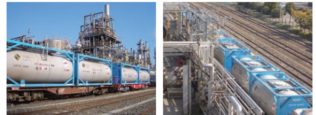
増強した当社主力製品(酸化エチレン)の鉄道タンクコンテナと荷役充填設備
